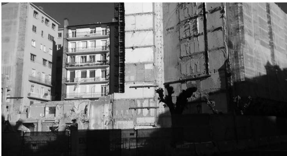
Figura 7.7 Imagen del vacío urbano tras la demolición de un cine en Pamplona. Fotografía de Alfredo Hoyuelos, 2019
